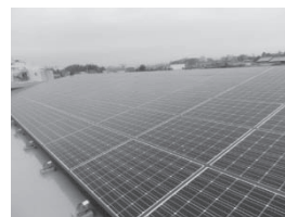
太陽光発電設備
