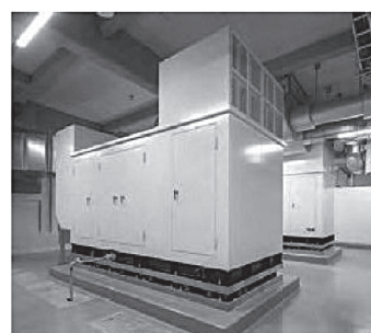
非常用発電機
