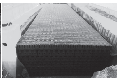
地下型貯留浸透槽
